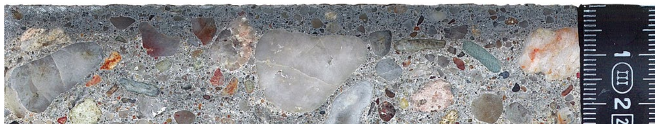
Die veränderte Verdichtungsstruktur unmittelbar unter der Betonoberfläche ist eindeutig sichtbar.
